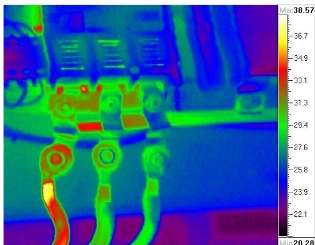
Рисунок 21. Пример термограммы контактных соединений с температурной шкалой
