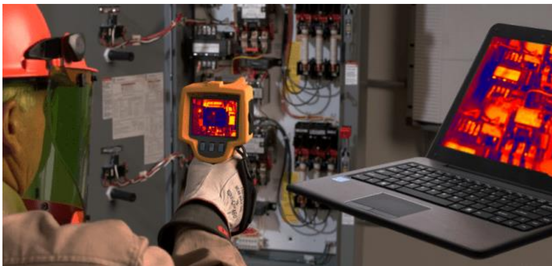
Рисунок 20. Пример проведения тепловизионного контроля электрошкафа
